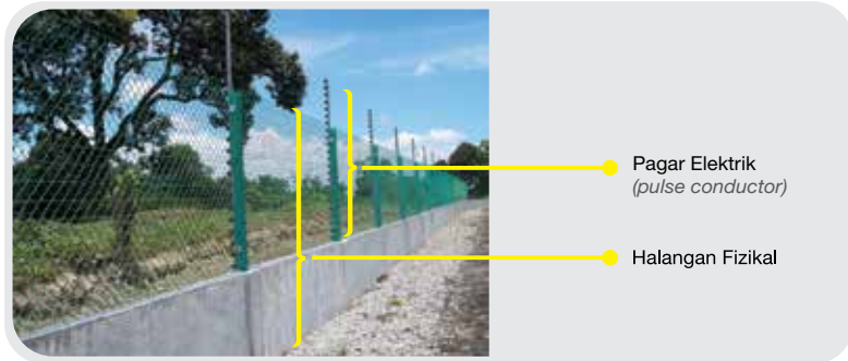
Gambar 6 : Halangan fizikal jenis kombinasi dinding konkrit dan pagar dawai, dibina dengan ketinggian sekurang-kurangnya 1.5 meter dari aras tanah/lantai. Pembinaan pagar elektrik dipasang bermula pada atas dinding konkrit tersebut.
