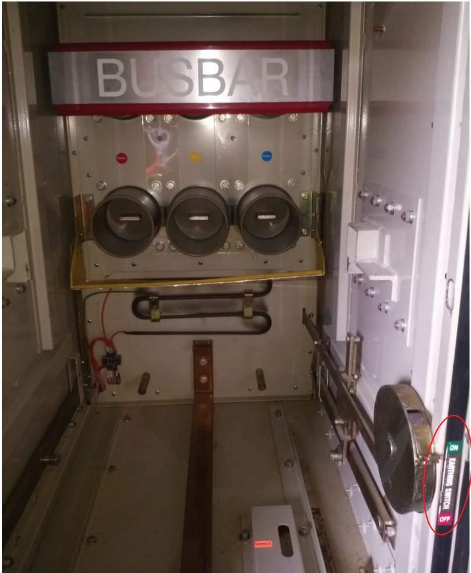
Gambar 4: Kunci dan Notis tidak dipasang pada Suis Cable Earth yang telah dimatikan Sepenuhnya (totally dead)
