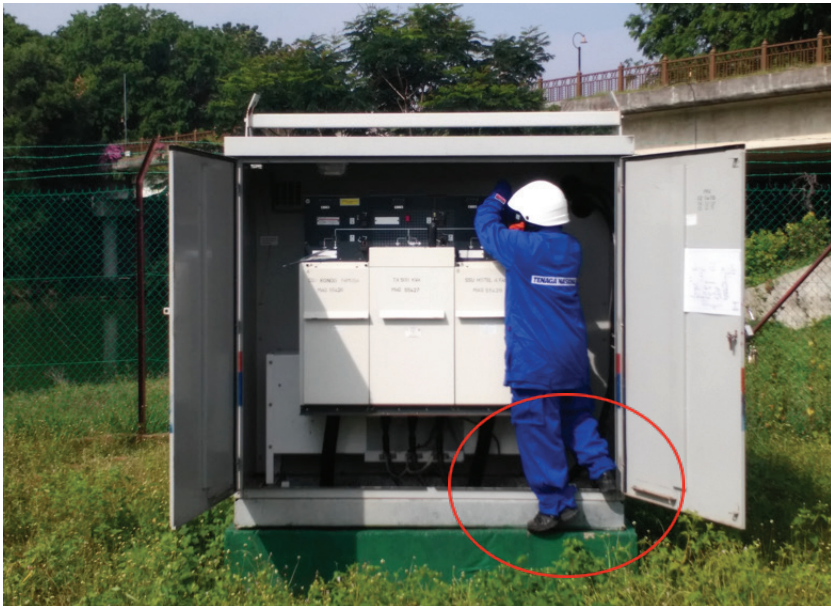
Gambar 9: Ruangan Kerja yang Tidak Mencukupi bagi Kerja Pensuisan yang Selamat
