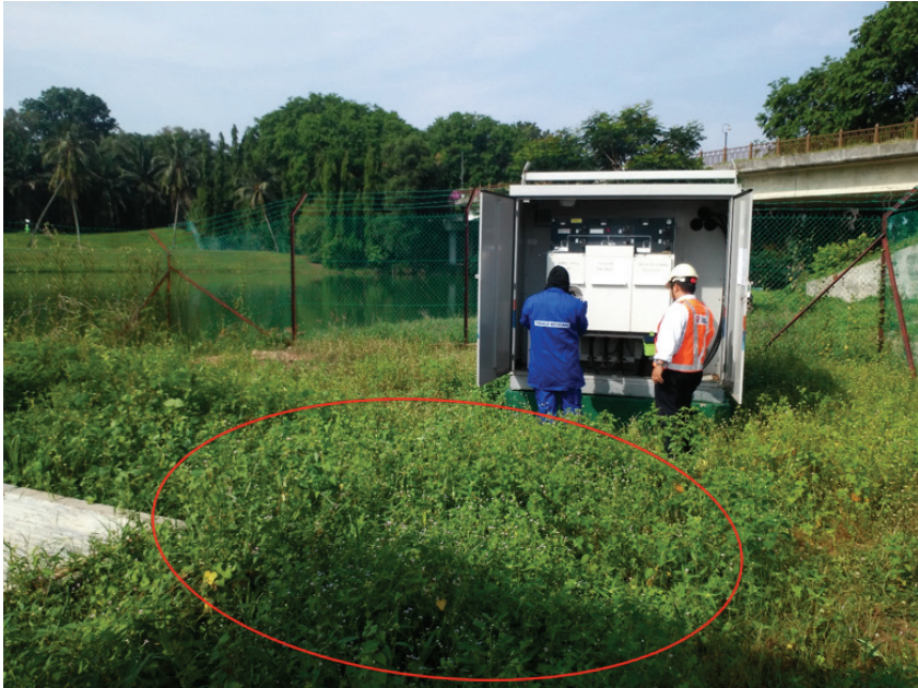
Gambar 8: Kawasan Pencawang Elektrik Dipenuhi Semak Samun kerana Tidak Diselenggara dengan Sempurna
