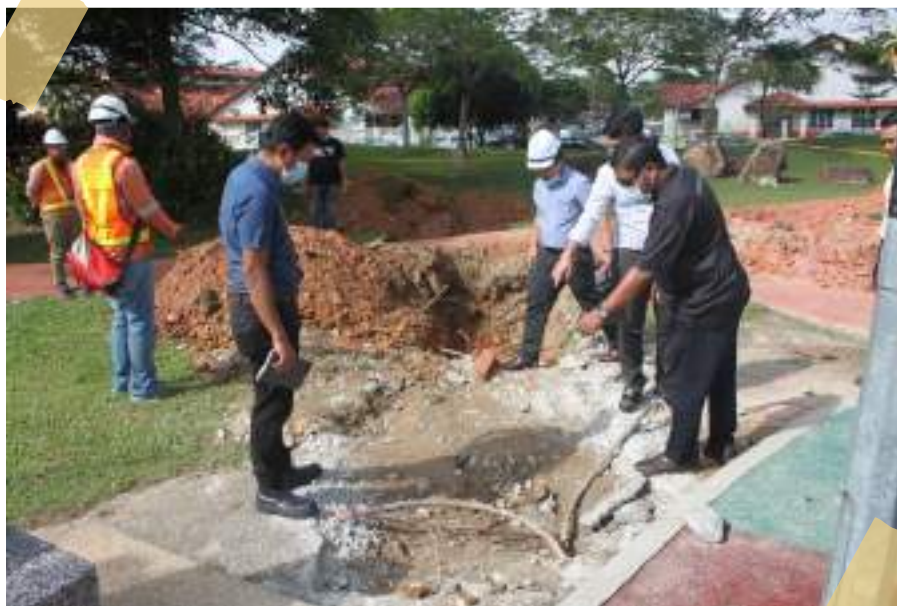
Gambar 12.8: Lokasi dimana kabel bawah tanah ditemui.
