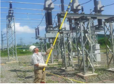
Gambar 11: Pemakaian Peralatan Perlindungan Diri (PPD) yang tidak lengkap ketika kerja-kerja pensuisan dijalankan di tapak (tidak memakai pakaian kalis percikan arka).
