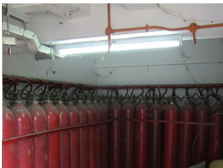
Gambar 10: Keadaan dalam bangunan pencawang yang tidak diselenggara dengan baik (peralatan dipenuhi dengan sawang dan sarang labah-labah).
