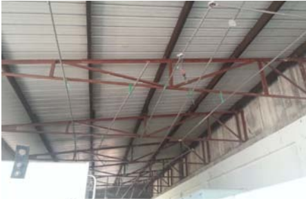
Gambar 7: Keadaan dalam bangunan pencawang yang tidak diselenggara dengan baik (tiada punca pencahayaan).
