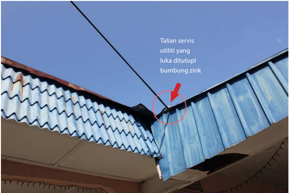
Gambar 21: Talian servis utiliti yang ditutupi oleh bumbung zink.
