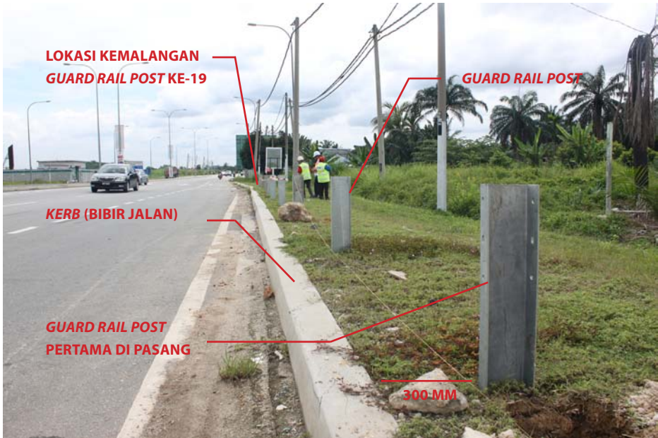
Gambar 16: Guard rail yang ditanam di bahu jalan di lokasi kemalangan. Berdasarkan standard pemasangan biasa, jarak guard rail dari kerb jalan adalah 300mm.
