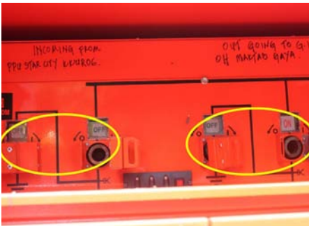
Gambar 5: Pintu RMU dan radas yang terlibat dengan kerja pensuisan tidak dikunci dengan kunci bukan piawai ( Non Standard Lock ) dan diletakkan notis awas dan bahaya.
