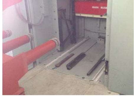
Gambar 12: Peralatan dan radas yang terlibat dengan kerja pensuisan tidak dikunci dan diletakkan notis awas & tanda bahaya.
