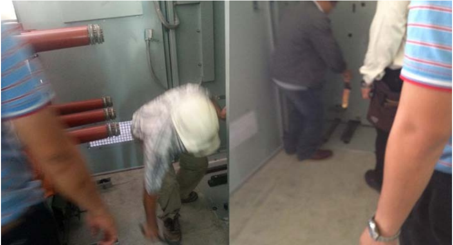
Gambar 14: Tidak menggunakan pelapik getah keselamatan ketika kerja-kerja di hadapan panel voltan tinggi.
