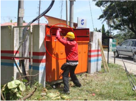
Gambar 3: Pemakaian Peralatan Perlindungan Diri (PPD) yang tidak lengkap ketika kerja-kerja pensuisan dijalankan di tapak.
