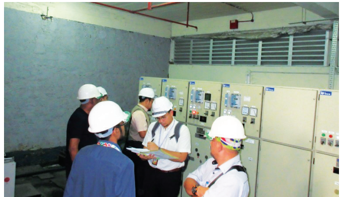
Pemeriksaan ke atas meter penyewa premis yang tidak berdaftar untuk Lesen Pemasangan Awam.
