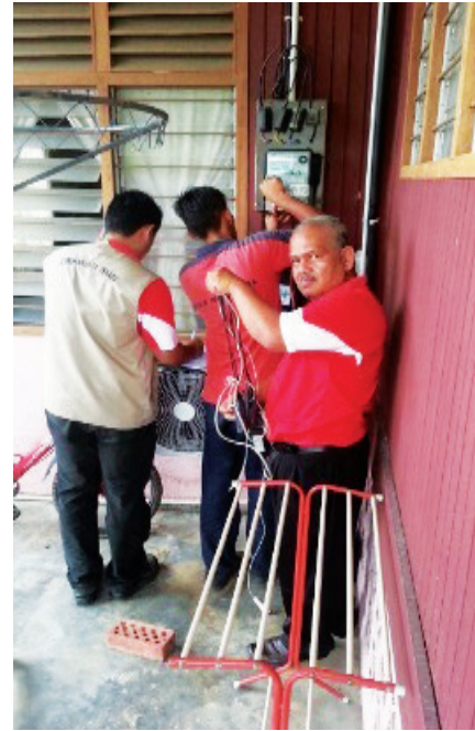
Pemeriksaan kejitaan meter elektrik pada premis yang disyaki membuat sambungan secara terus tanpa melalui meter.
