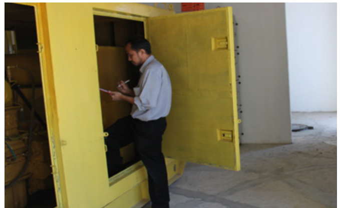
Pemeriksaan pemasangan elektrik bagi tujuan pendaftaran.
