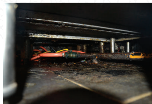
Paip gas yang tidak disenggara dengan sempurna sehingga berkarat.
