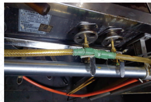
Hos gas bocor dibalut dengan pita yang tidak bersesuaian.
