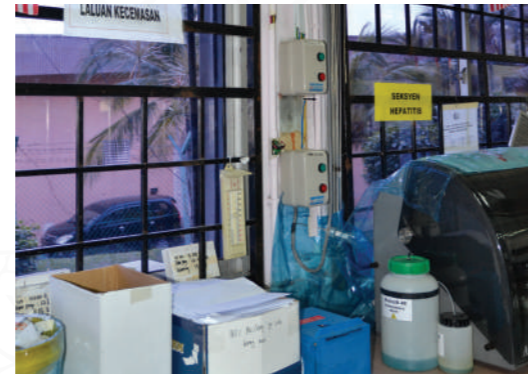
Soket suis yang terdedah kepada air.
