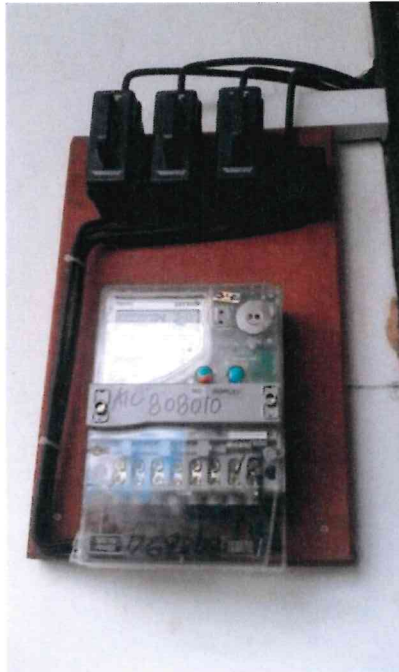
Foto Pendawaian Terbuka Pada Papan Meter
